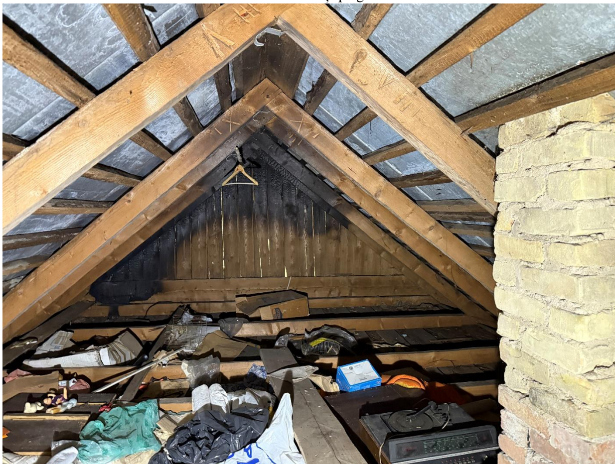
20. att. Ēkas bēniņi piegružoti. R puses zelminis un jumta konstrukcijas savulaik degušas
