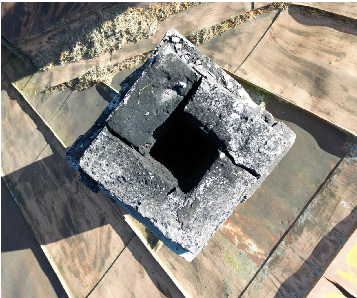
11. att. Apdares un mūra erozija, izdrupumi skursteņa virs jumta daļā
