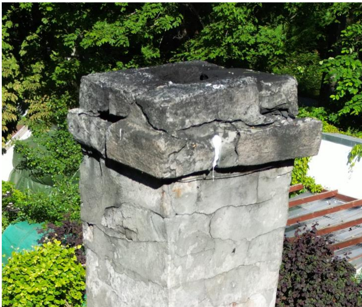
9. att. Apdares un mūra erozija, izdrupumi skursteņa virsumta daļā
