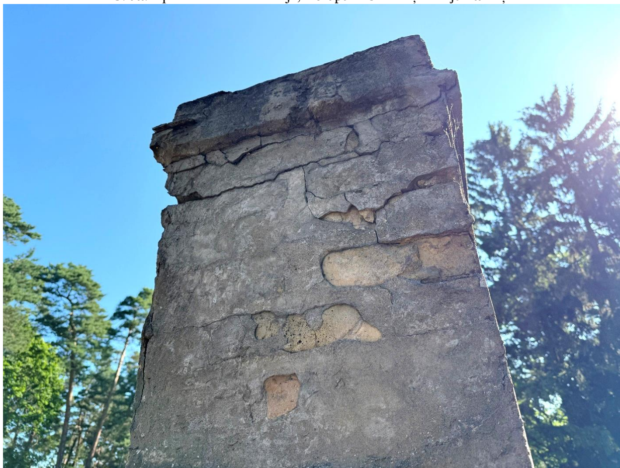
10. att. Apdares un mūra erozija, izdrupumi skursteņa virsumta daļā
