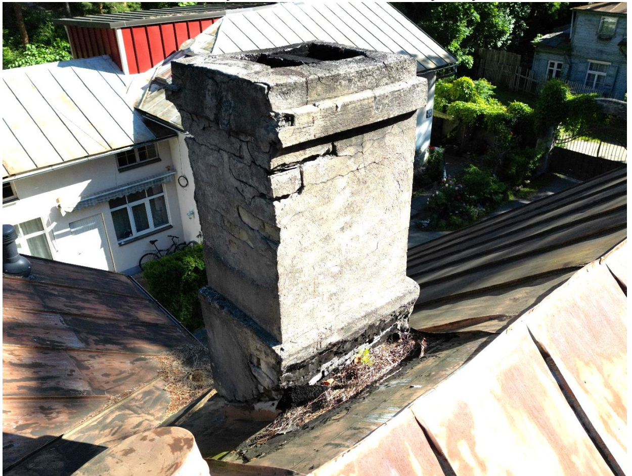
8. att. Apdares un mūra erozija, izdrupumi skursteņa virsjumta daļā
