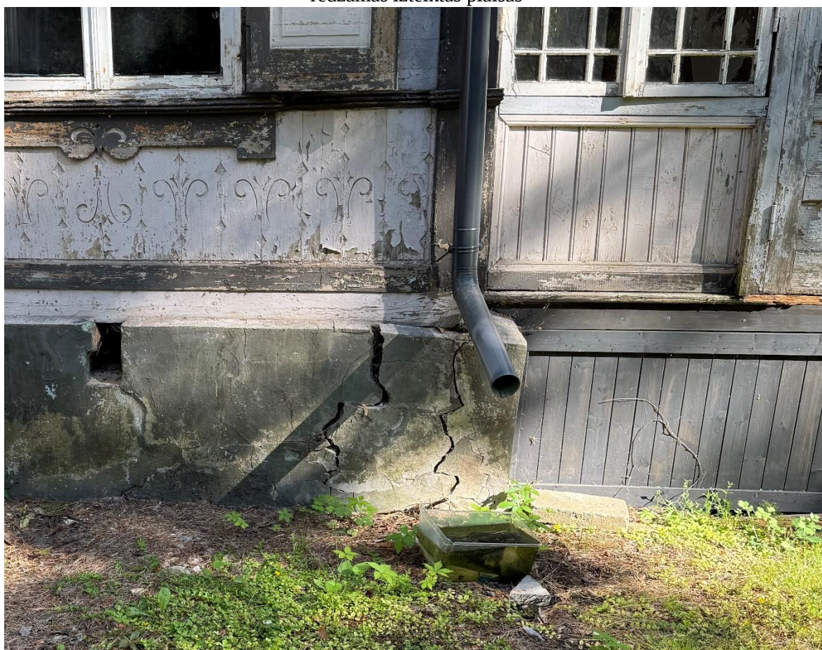
16. att. Lietus ūdens noteksislēmas notekcaurules nokrišņu ūdeni novada tvertnē pie pamatiem, tvertnei pārpļūstot, ūdens nonāk, uzkrājas un skalojas gar pamatiem. Virspamatos redzamas izteiktas plaisas
