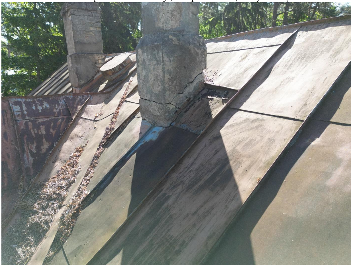
12. att. Apdares un mūra erozija, izdrupumi skursteņa virs jumta daļā
